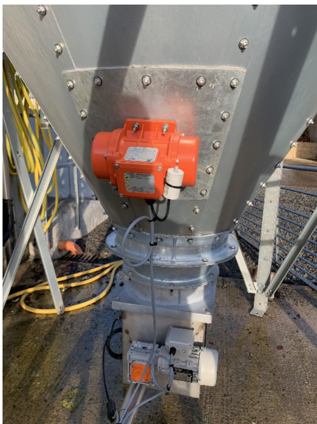
شکل ۴- نصب ویبراتور روی دیواره‌ی قیف تخلیه در شرایط واقعی.
